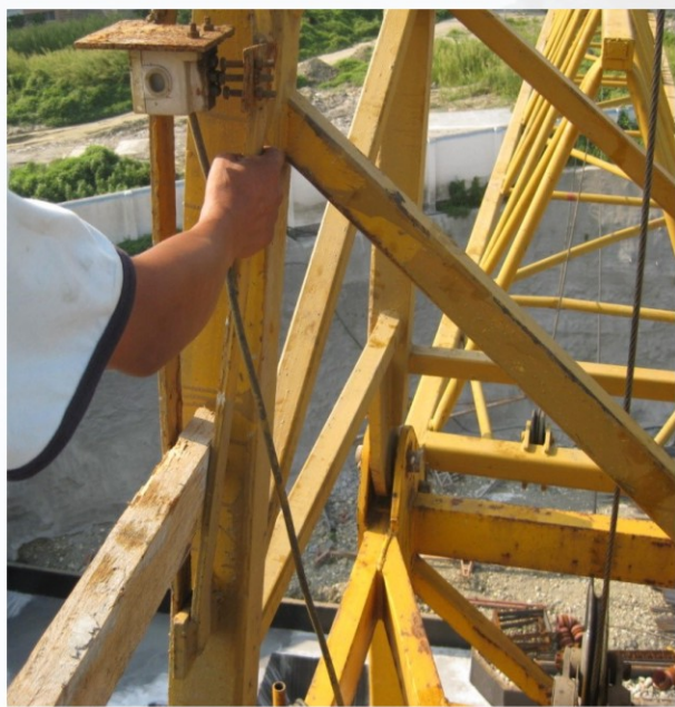
力矩限位卡牢可能导致塔吊倒塌
